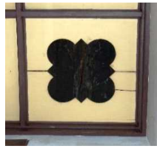
教室天井の通気孔
