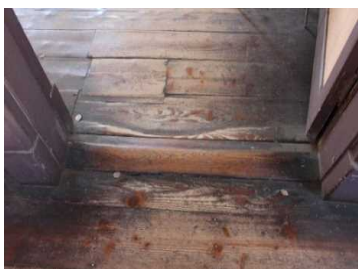
摩耗した扉の見切り板
